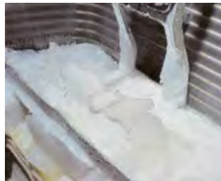
Eisbildung am Außengerät ohne Wannenheizung
